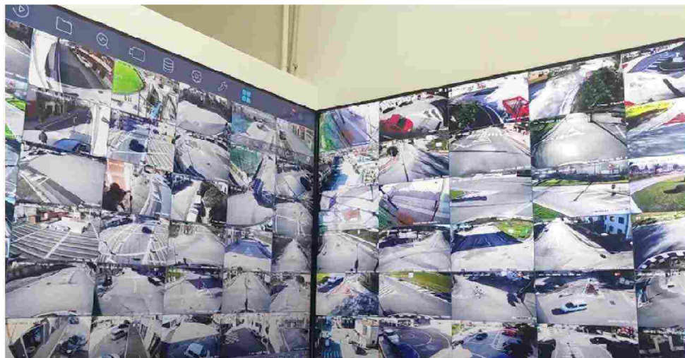
Un particolare della "control room" realizzata a Lioni nell'ambito del progetto di smart city Borgo 4.0.
